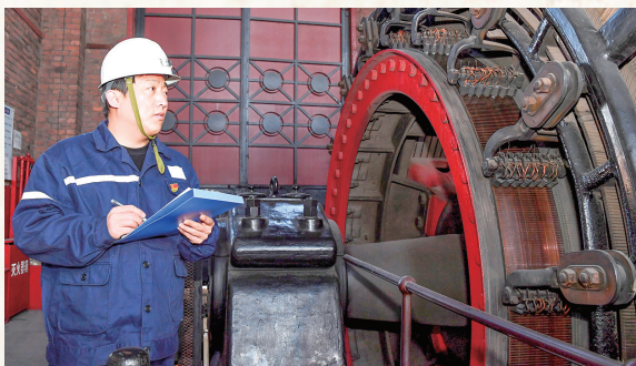
熊旭东在绞车房检修设备。 唐山矿供图
