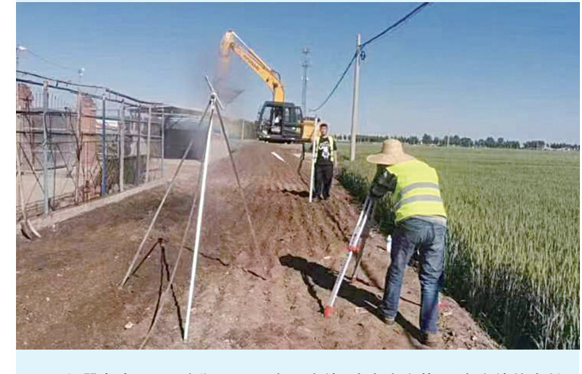
机器轰鸣,近日,丰润区2024年度“四好农村路”建设火热开启。该区农村公路改造提升工程,是今年的民生实事工程,共涉及小张各庄镇、欢喜庄乡等12个乡镇的农村公路116.3公里,总投资7200万元,计划10月底前全部完工。
