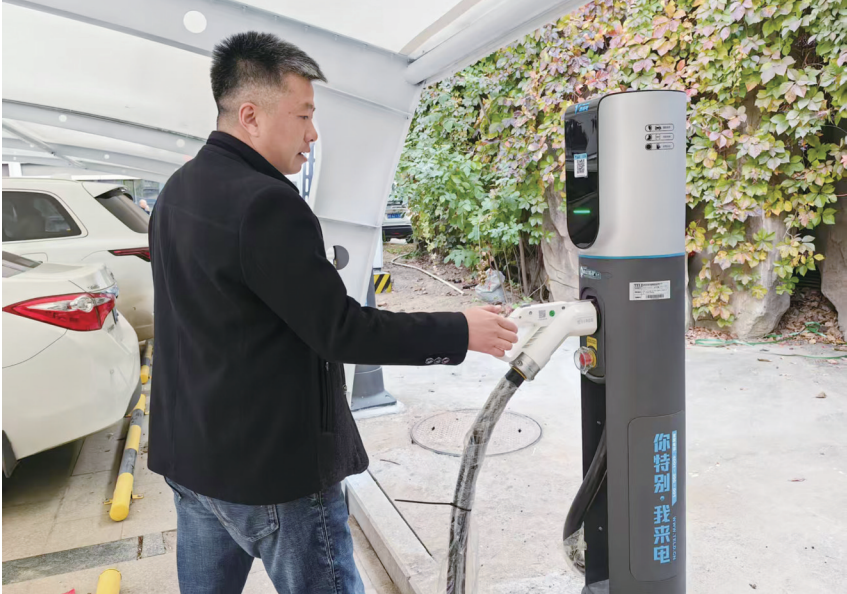
图为居民正在使用充电桩为自家电动汽车充电。市新能源集团供图
