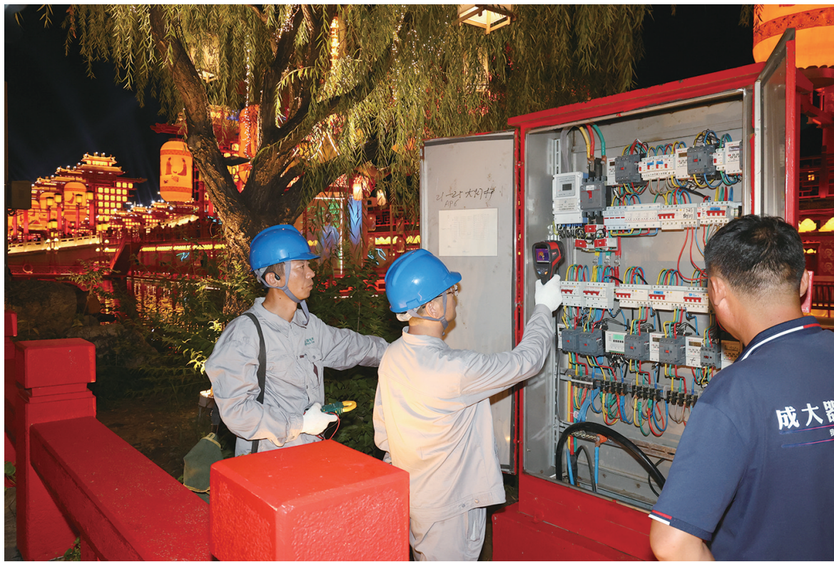
图为国网唐山供电公司工作人员为保证节日旅游安全在河头老街景区检查配电箱用电设备。周宇翔摄
