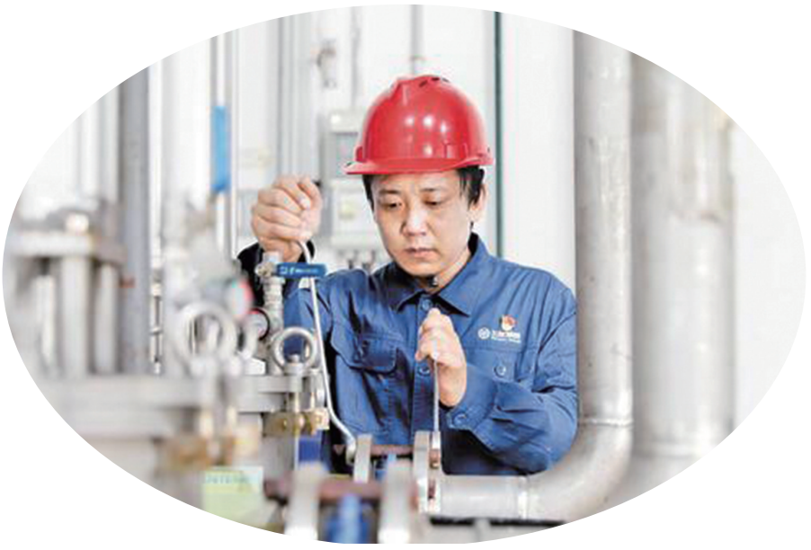
近日,在唐山三友集团化纤公司,工人正在安装自主设计的丝束控制器。贾磊 摄
