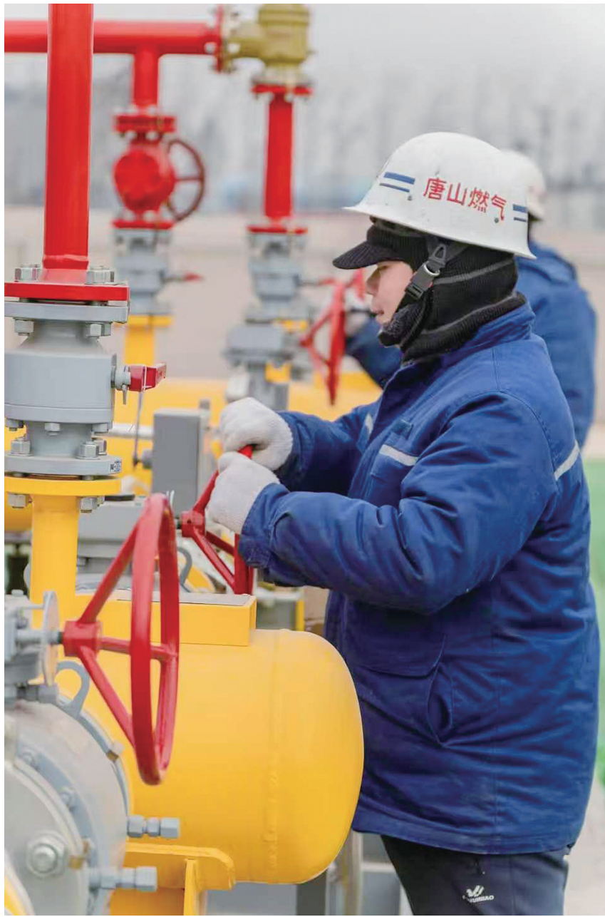
图为市燃气集团门站职工正在对燃气设备进行维护。 燃气供图
