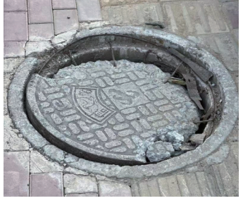
图为之前破损的井盖。问政人供图
