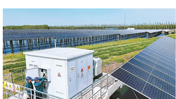
▲图为国网玉田县供电公司员工在光伏电站开展巡检作业。
